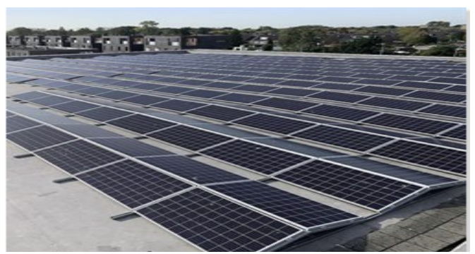
Installatie Sportcentrum Papendrecht.
