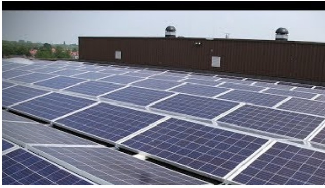
Installatie Maria Montessorilaan Dordrecht.
